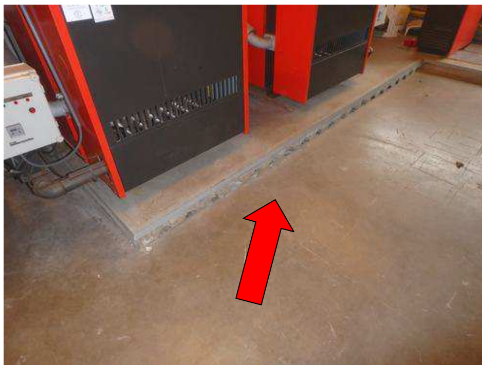
golfplaten onder opstort van cv-ketels
