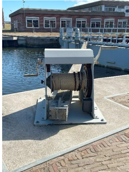
Figuur 13. Aandrijving Boerenverdrietsluis.
